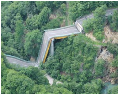
図2 橋梁の破壊・落下の状況
