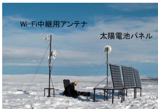
図 1 中継アンテナ及び太陽電池パネル
