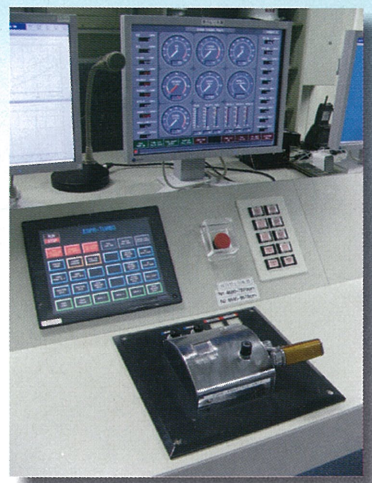
エンジンオペレータ操作盤 (Engine Operator Panel)
