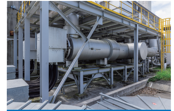
空気加熱器 Air heater
