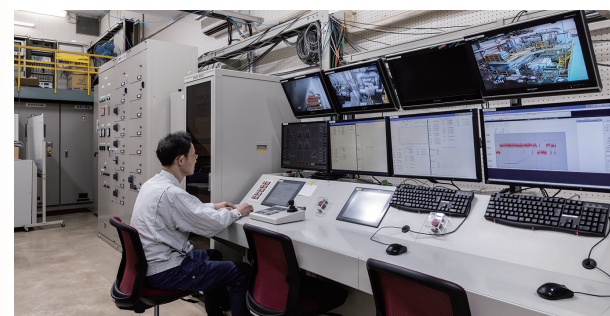
制御室 Control room
