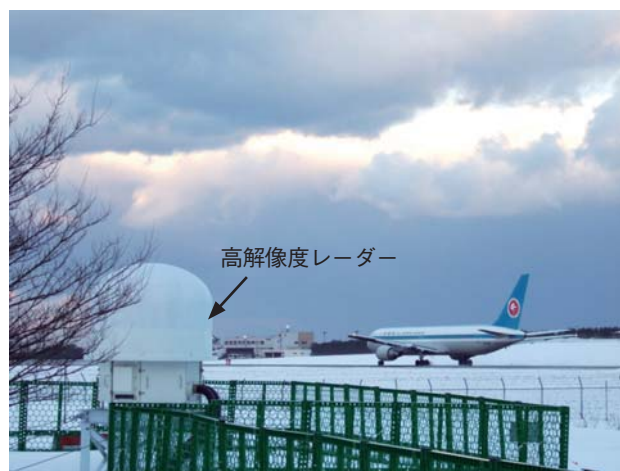
図2 ● 庄内空港に設置した高解像度レーダー
