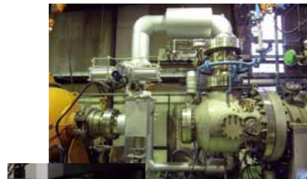
実エンジン環境材料試験設備 実際と同様の使用環境で、タービンの材質などの試験を行う。
