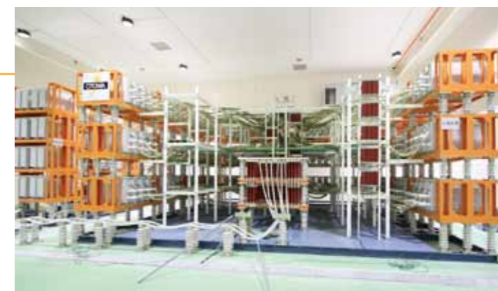
耐雷試験装置(発生器)
