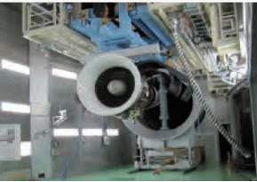
エンジン地上運転試験設備
