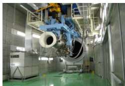
地上エンジン運転 試験設備
