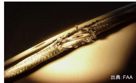
損傷した配線
