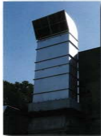
排気消音塔 (Exhaust Silencer) ファンや圧縮機の供試体から排出された作動空気を屋外に放出するとともに、屋外への騒音を遮断します。
