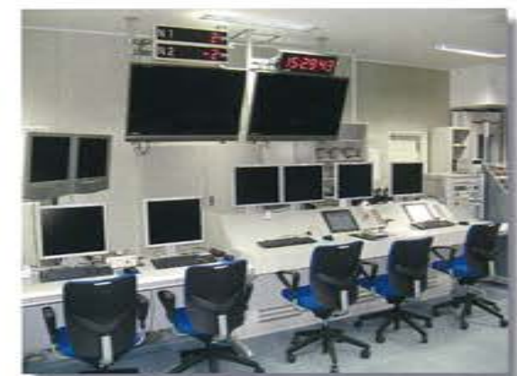
運転計測室 (Operation Room)
