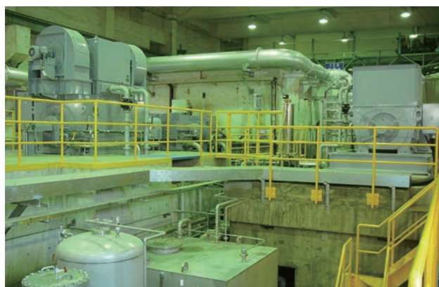
回転要素試験設備概要 JAXAの回転要素試験設備はファンや圧縮機を要素単体で試験を行う電動機駆動の設備で8MW系と2.2MW系の2系統からなっています。
