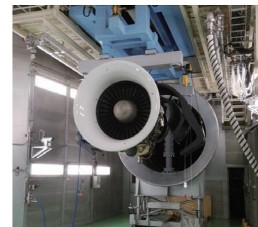
エンジン運転セル Jet Engine Test Cell
